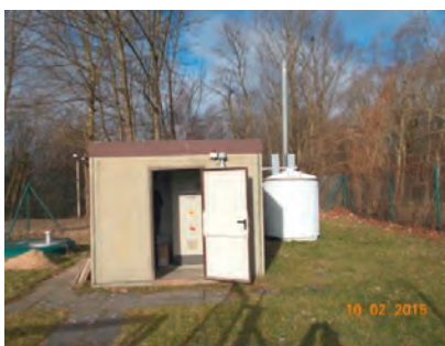
In der Gasverdichterstation wird das Deponiegas abgesaugt und dann schadlos beseitigt
