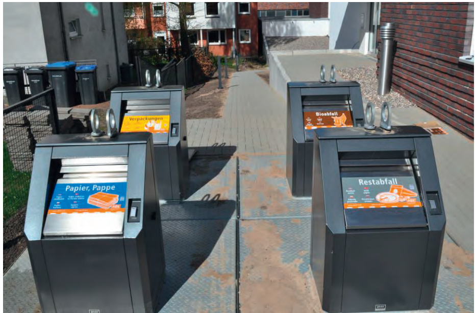
Mehr Qualität für das Wohnumfeld größerer Wohnanlagen: Unterflurbehälter
