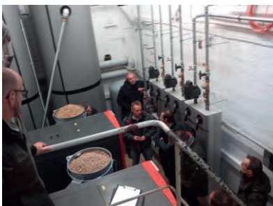
Inbetriebnahme der Pelletanlage Grundschule Kronsburg
