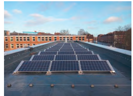
Photovoltaik-Anlage Hans-Christian-Andersen Schule auf Mensaneubau
