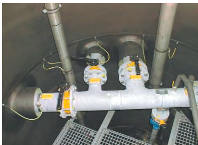
Blick in den Kondensatschacht des aktuellen Gasfassungssystems
