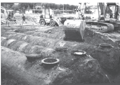
Sanierungsmaßnahme „Querkaï“; ehem. Tanklager, Verunreinigungen durch Mineralöl- und Benzinkohlenwasserstoffe
