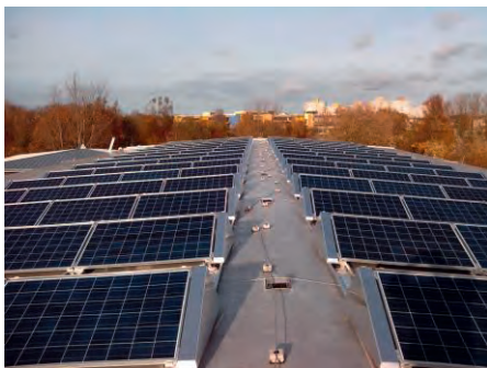
PV-Anlage Heidenberger Teich (30kWp)
